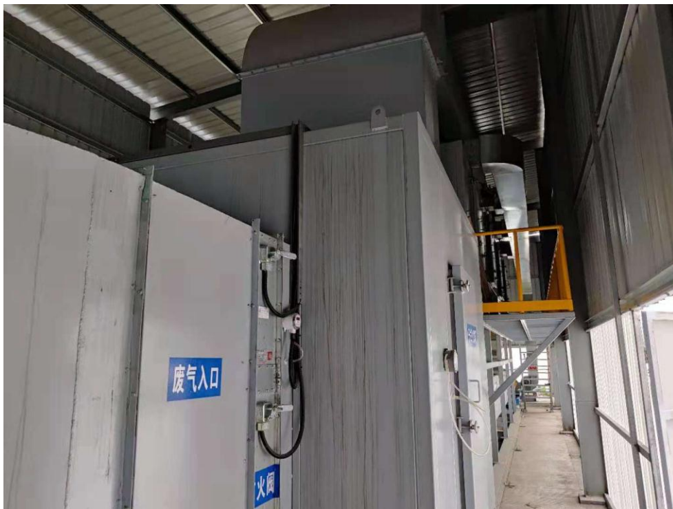
图 4-5 油漆废气处理装置
