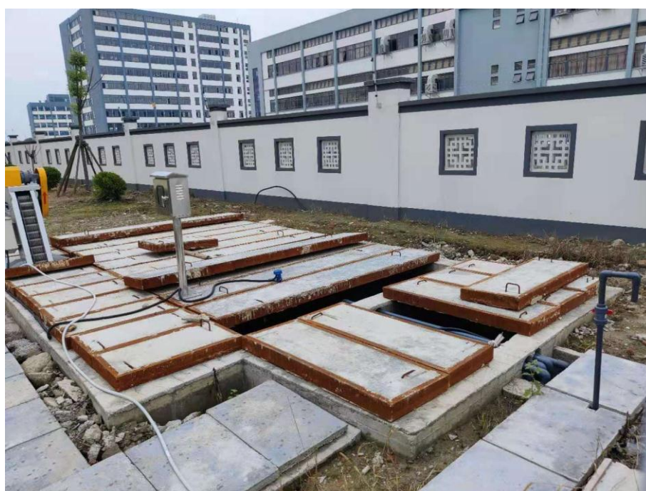
图 4-2 泥膜一体化污水处理系统设施图
