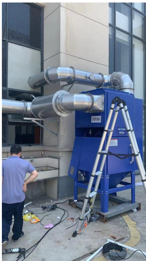
图 4-7 焊接废气处理装置
